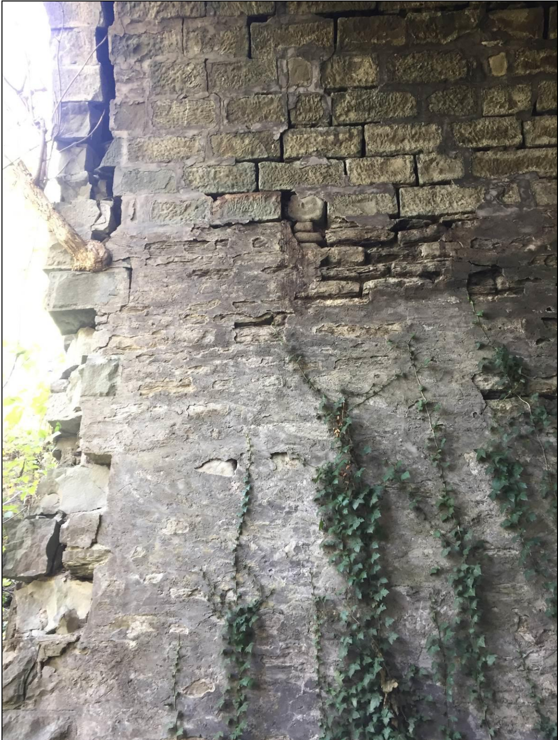
Figura 3 – Particolare della lesione della volta a valle e dell'arbusto radicato sul manufatto
