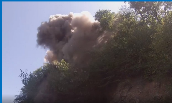
Intervento di Bedonia per la manutenzione mediante il ricorso a cariche esplosive
